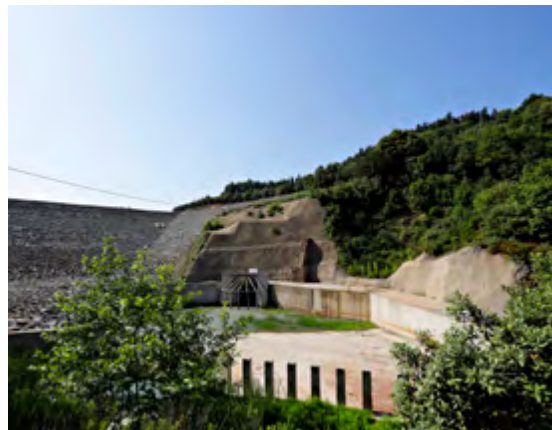
Η εκτροπή του ρέματος Κοκκινόλακκα έχει επιτευχθεί μέσω σήραγγας με επένδυση από σκυρόδεμα για την αποτελεσματική εκτροπή του νερού από τον χώρο απόθεσης
